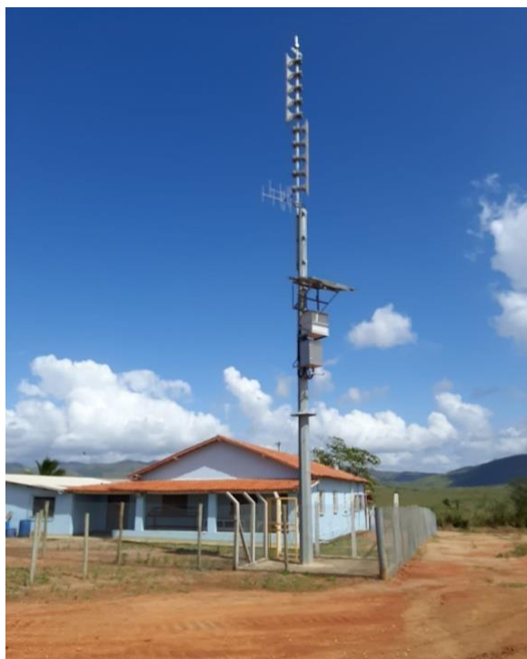
Figura 11.1 – Sirene implantada próximo a mancha hipotética de inundação da Barragem Califórnia
